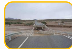
Schade aan infrastructuur
